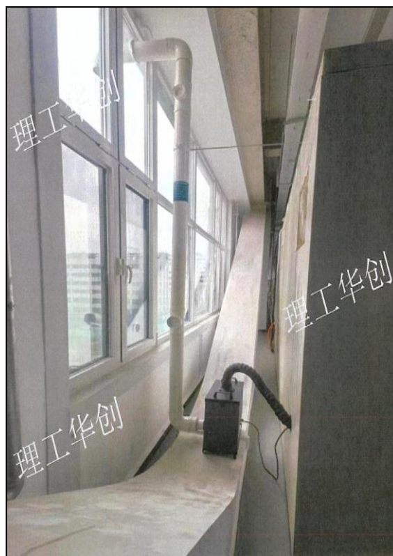
焊接废气排气筒
